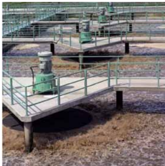
下水処理プラント
